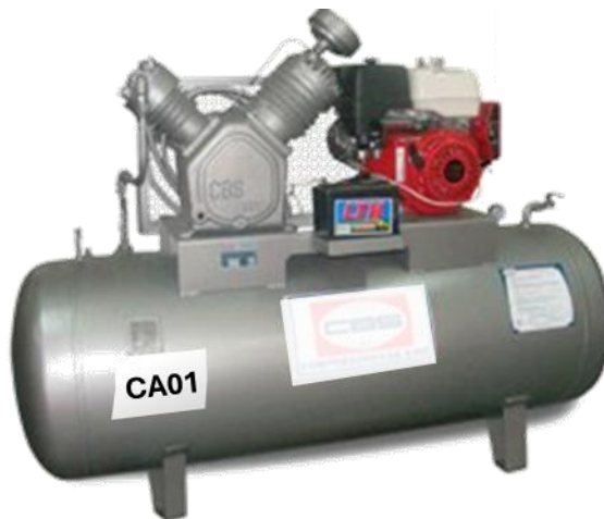
Figura 27. Identificación del compresor de aire 01
