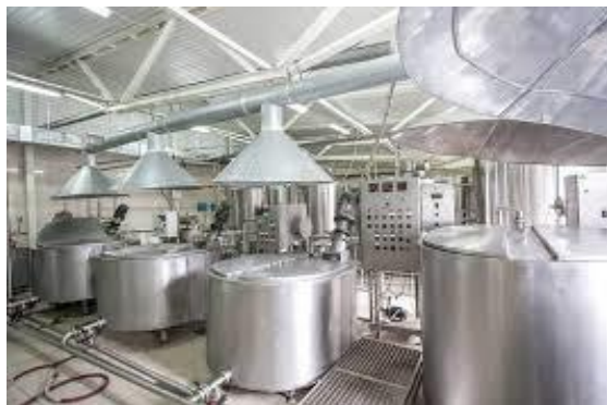
Figura 25: Equipos de industria con acero inoxidable.
