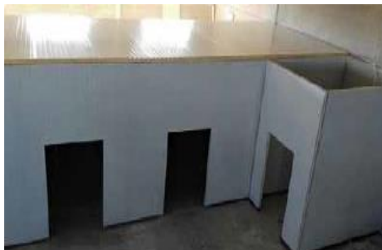
Figura 23: Paneles sándwich de cámaras frigoríficas.
