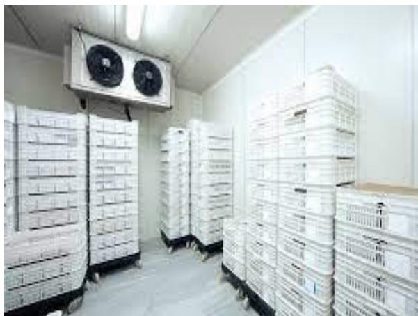
Ilustración 4. 128. Vista interior de una cámara para el almacenamiento refrigerado.
