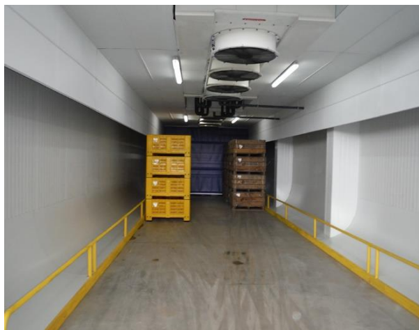
Ilustración 4. 129. Interior de una cámara para el preenfriamiento por aire forzado.
